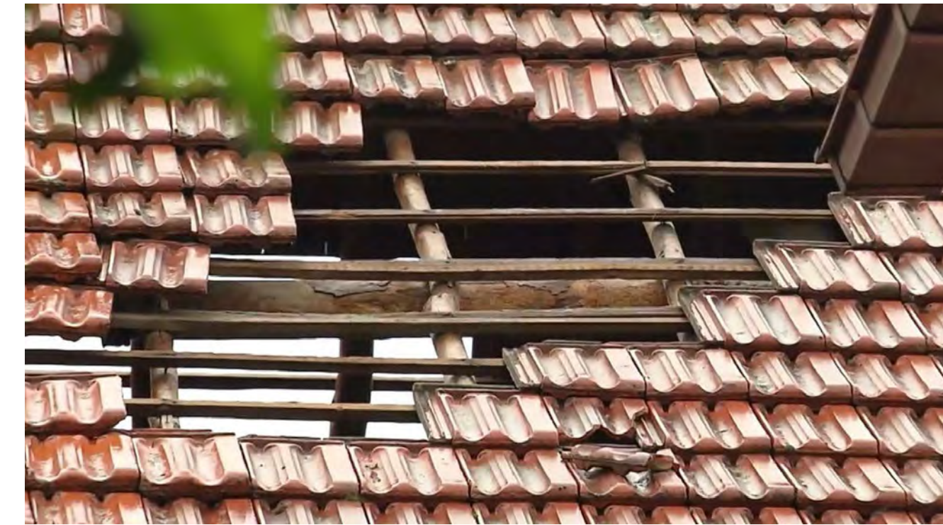
— Figuur 1.2: Voorbeeld van schade door wervels (nos.nl)
