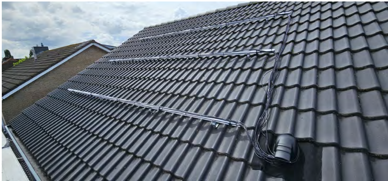
— Figuur 3.1: Rails met drukmeters op het dak
