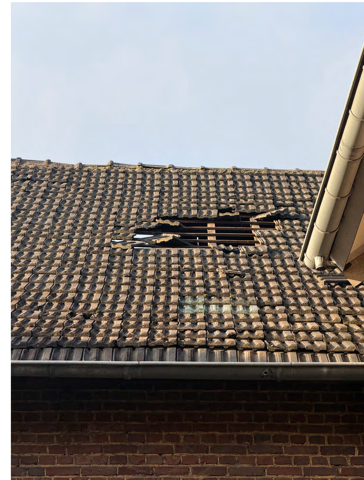
— Figuur 6.16: Schade aan dakvlak zuidoost zijde woning.
