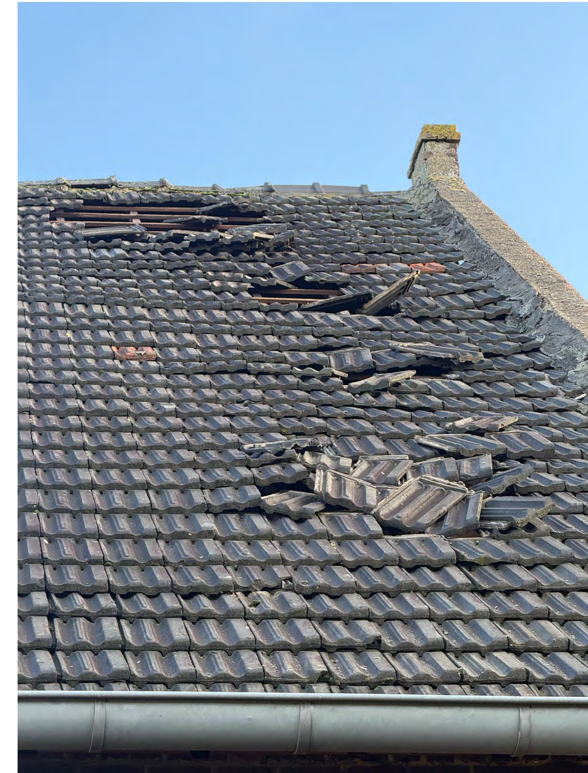
— Figuur 6.15: Schade aan dakvlak noordwest zijde woning.
